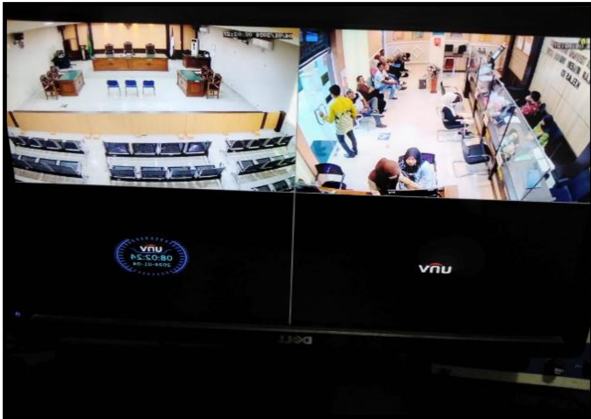
CCTV pada PTSP
